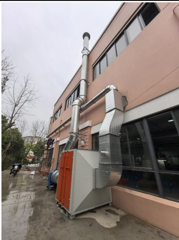
活性炭吸附处理装置
